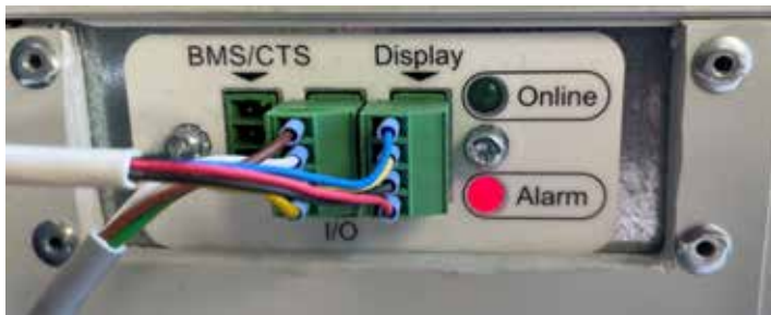
Billede 2: Bagsiden af styresystemet, hvor Phønix-stikket fra brandboksen er indsat i I/O-indgangen.
